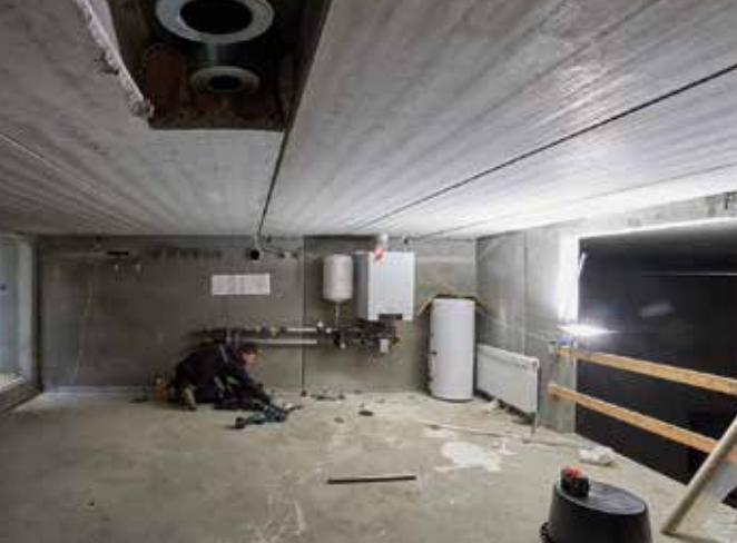
Et af flere ventilationsanlæg på vej til at blive tilsluttet i et af teknikrummene.
