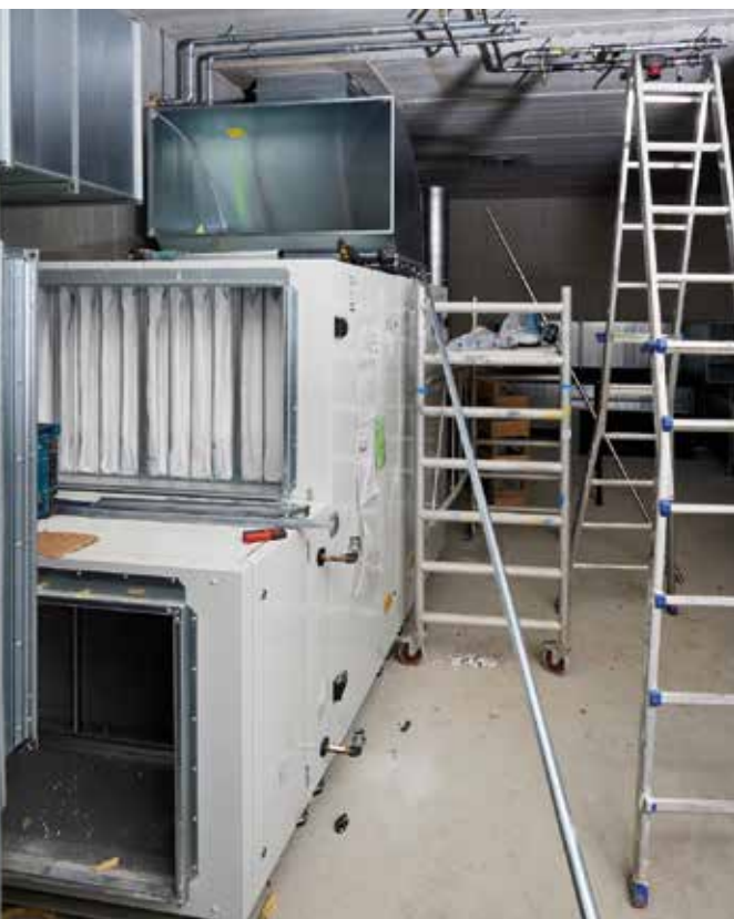
Et af flere ventilationsanlæg på vej til at blive tilsluttet i et af teknikrummene.
